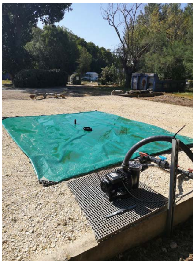
Bâche de réception des eaux usées traitées à la STEP de Maussane-les-Alpilles
